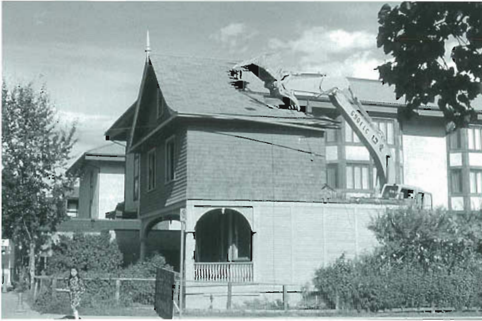
Jusqu'à tout récemment, de nombreux vieux bâtiments à Banff (Alberta) ont été démolis pour faire place aux installations plus récentes et plus grandes de l'industrie touristique en pleine croissance. De nos jours, il y a une sensibilité accrue face à la valeur patrimoniale du parc de bâtiments anciens de cet endroit de villégiature.
